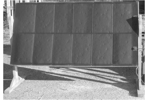
Fig. 5. 97W flexible PV module.
